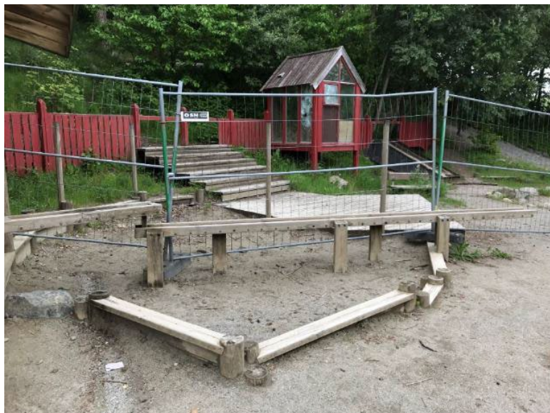
Figur 14: Lekeområde. Lekehytte i dårlig stand.
